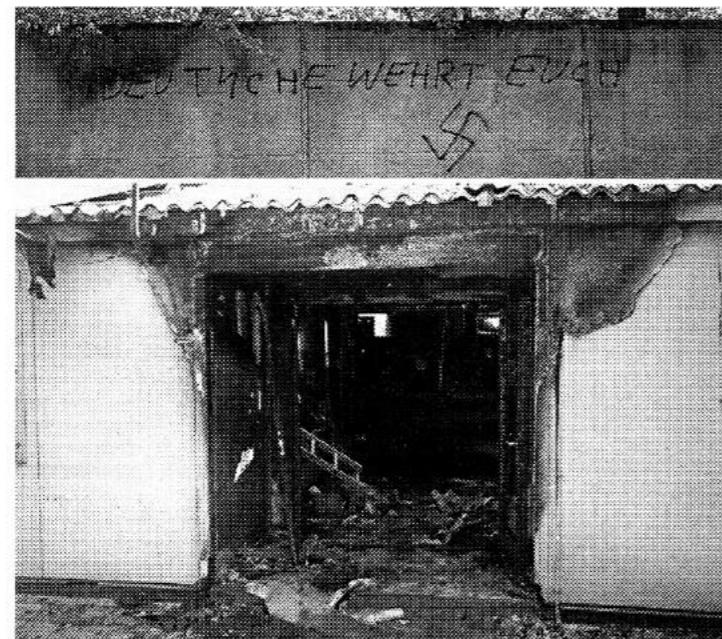
Die Außenmauer vor der völlig ausgebrannten Flüchtlingsbaracke ist mit mehreren faschistischen Parolen wie „Deutsche wehrt euch!“ und „Asylanten raus“ verschmiert worden. Warum haben die Behörden und die Polizei nicht früher schon die Entfernung dieser Parolen veranlaßt?
