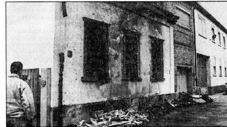
Deutliche Ruß- und Rauchspuren: Dieses Haus in der Bauernwiesenstraße in Friesenheim wurde in Mitleidenschaft gezogen. (Foto: Kunz)
